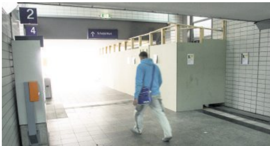
Hinter der Holzwand im Bahnhofstunnel arbeitet derzeit eine Firma aus Kroatien daran, einen neuen Aufzug zu den Bahnsteigen 2 und 4 einzubauen.
