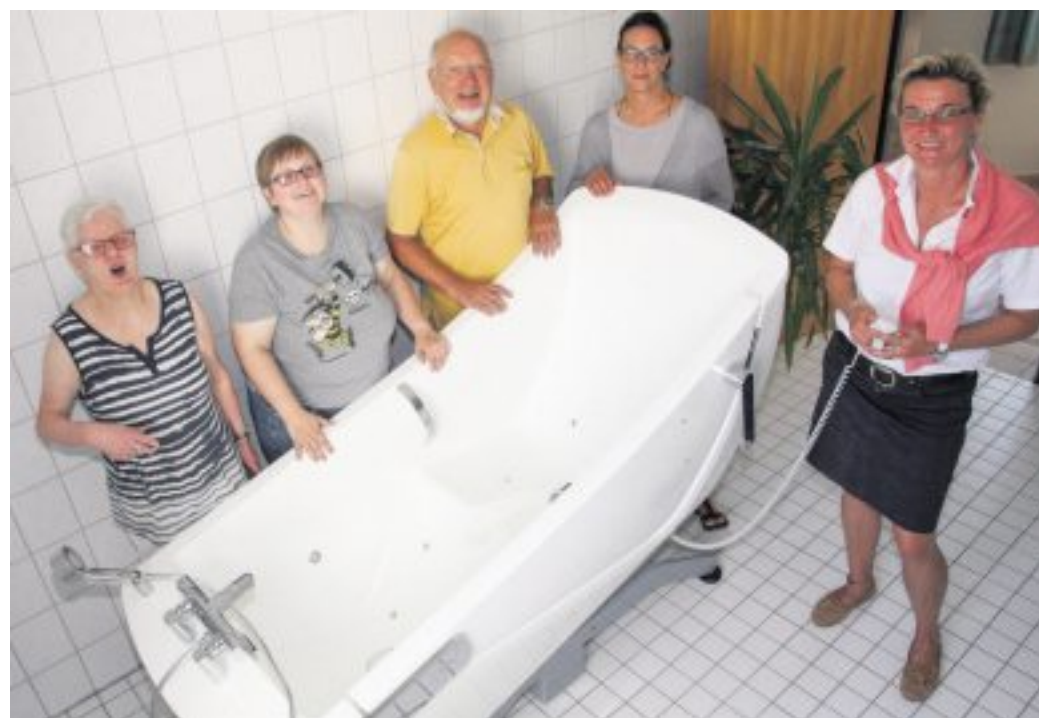
Die neue Pflegebadewanne ist eine große Hilfe, da sind sich (v.l.) die Bewohnerinnen Christel König und Sonngard Rolf, Stiftungsvorstand Manfred Witthus und seine Stellvertreterin Dagmar Richter sowie Wohnstätten-Leiterin Michaela Schmidt einig. —FOTO: RICHTER
